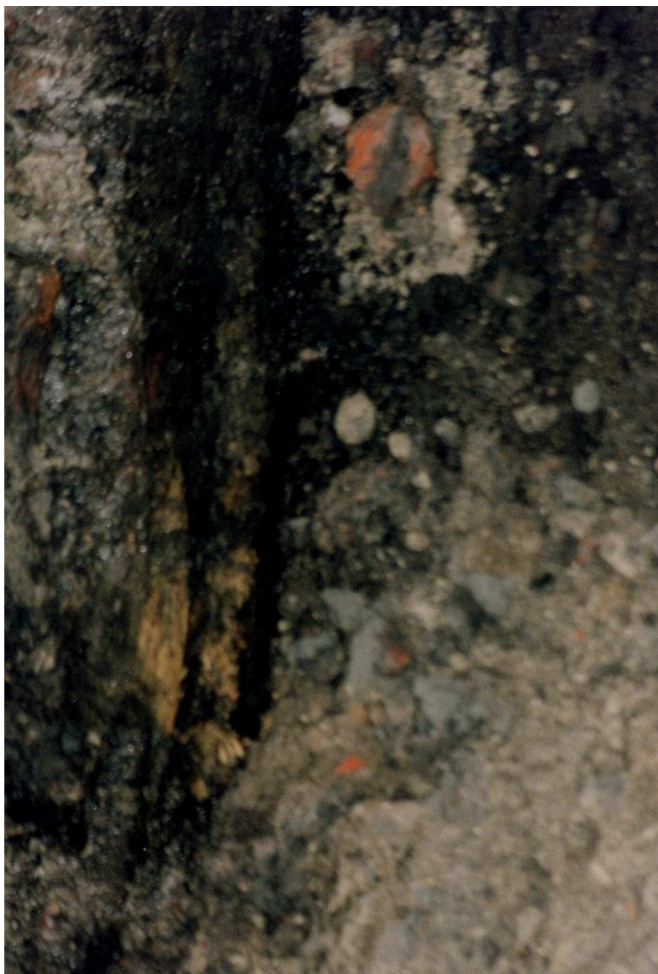
Foto 3: Goed te zien zijn de kopse einden van de onderliggende balklaag en de balklaag in de lengterichting. Iets boven de balklaag is puin te zien. Foto Boarnstra.
