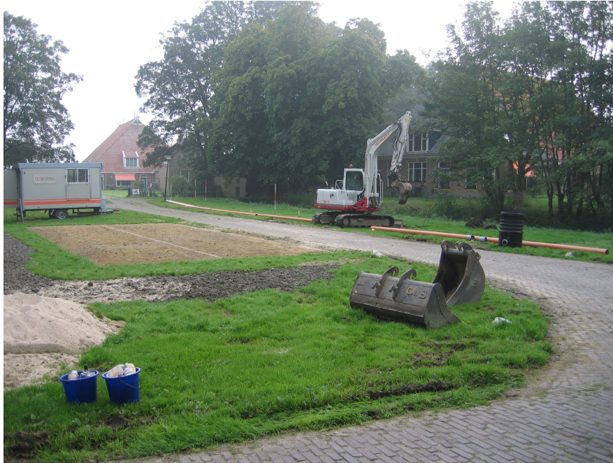
Afbeelding 3 Situatie van het onderzoeksterrein, voorafgaand aan de werkzaamheden. Foto: J.Y. Huis in 't Veld.
